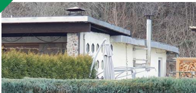
Sowohl der Edelstahlschornstein an dieser Gartenlaube als auch die errichtete Freisitzüberdachung verstoßen offensichtlich gegen das Bundeskleingartengesetz und die Rahmenkleingartenordnung. Hier besteht Handlungsbedarf.
