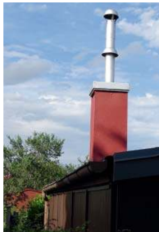
Durch die umfassende Sanierung bzw. den Austausch von Bauteilen bei diesem Schornstein dürfte der Bestandsschutz verloren gegangen sein.
